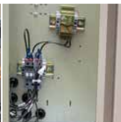
Tablilla de conexiones
