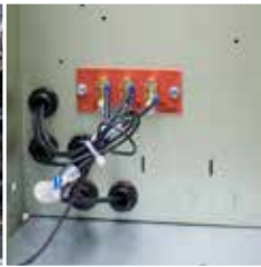
Tablilla de conexiones
