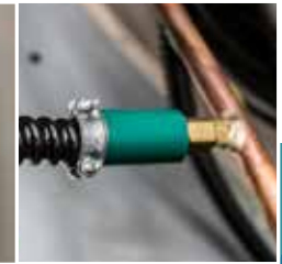
Control de alta presión
