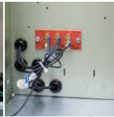
Tablilla de conexiones
